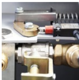
Desconexión de seguridad del tamiz abovedado en el interior
