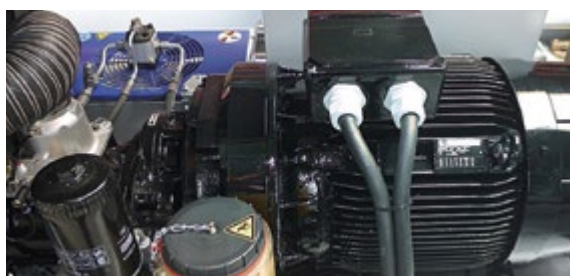
El motor eléctrico de 30 kW controlado por frecuencia
